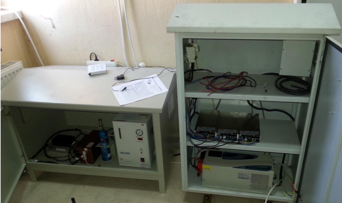
Resim 3.8 Hibrit güç üretim ve tüketim sisteminde enerji akış kontrolü için dizayn edilen panolar.
