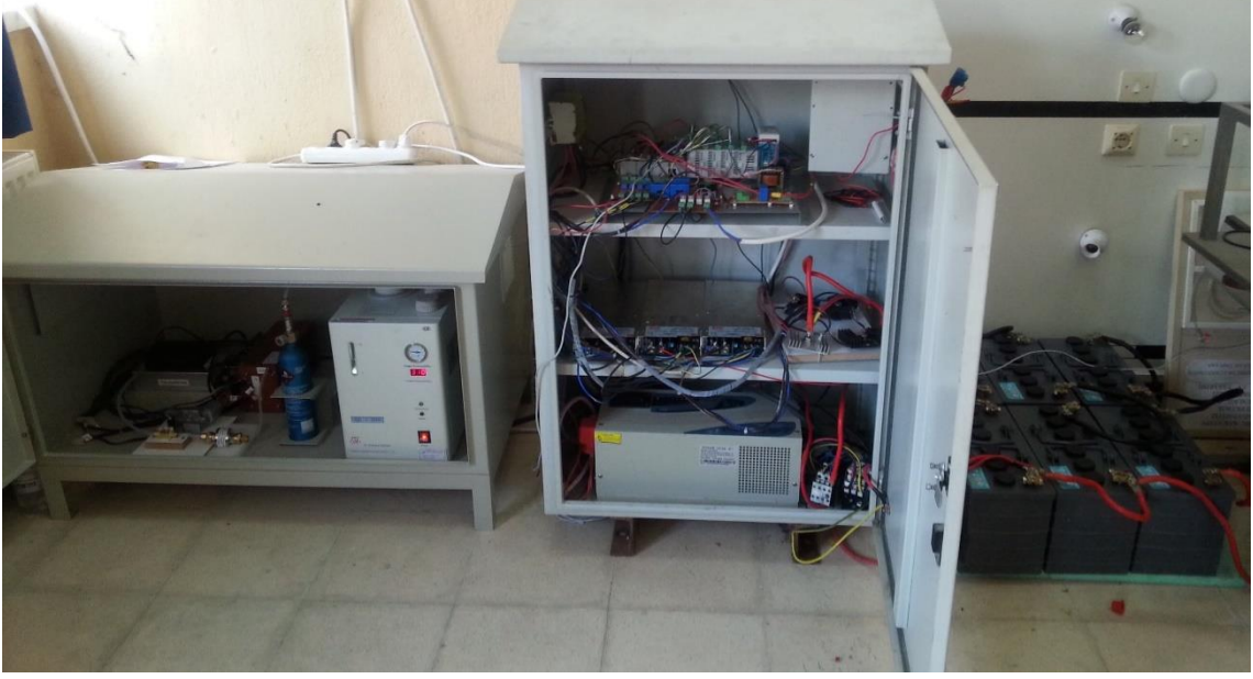
Resim 3.12 Hibrit güç kontrol ünitesi.
