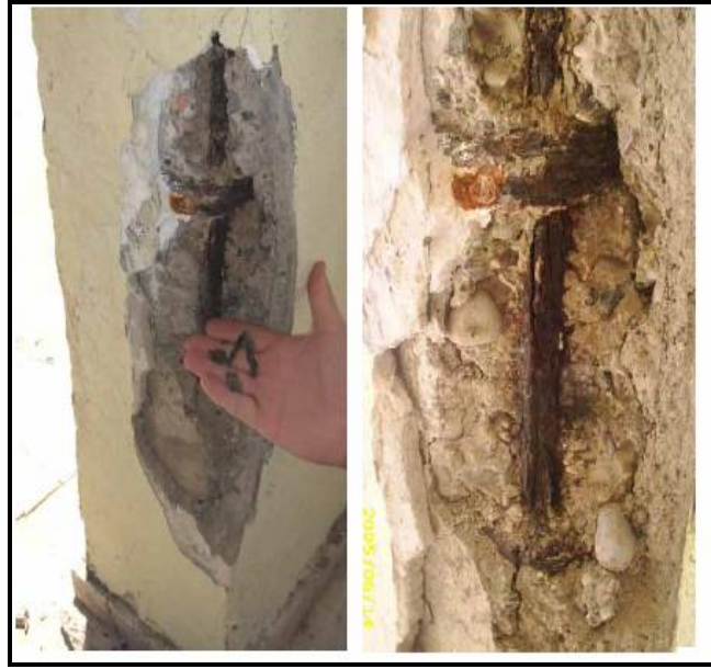
Resim 2.2 Donatının korozyon sebebiyle ufalanması (Kaplan vd. 2005).
