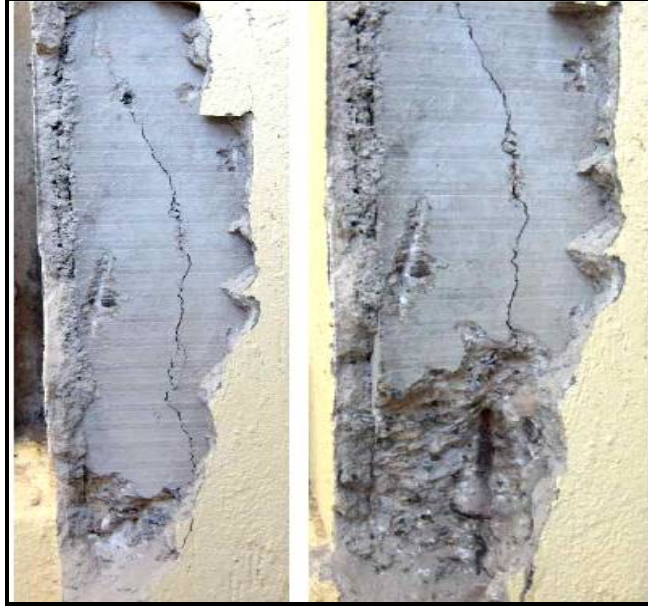
Resim 2.1 Donatıdaki korozyondan dolayı betonda oluşan çatlak ve beton kırıldığında içerdeki çelik donatının korozyonu (Kaplan vd. 2005).
