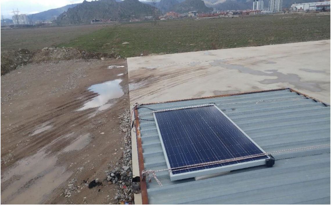
Şekil 4.2 Proje konteynırı üzerine monte edilen solar panel.
