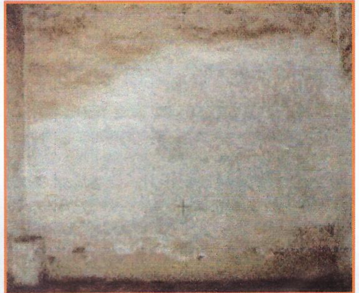
Şekil 6. Rutubetlenme nedeniyle renk değiştiren mermer yüzeyi
