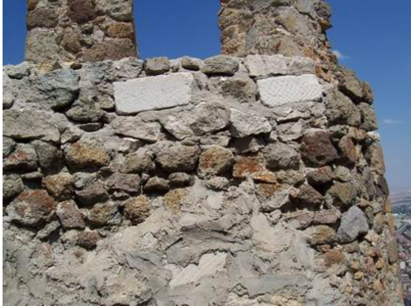
Şekil 1 Moloz taş duvarlarda kullanılan gelişigüzel yapılmış derz dolgularının görünümü.
