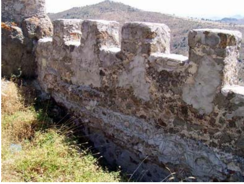
Şekil 2 Sur duvarlarında kullanılan ve göze hoş gelmeyen derz dolgularının görünümü.
