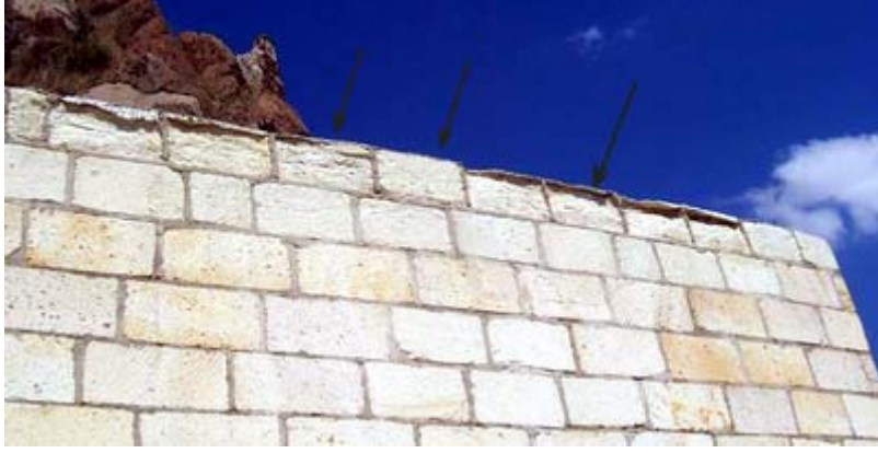
Şekil 10 Orta sur restorasyonu yapılan duvarlardaki kullanılan tüflerde görülen bozuşmalar.
