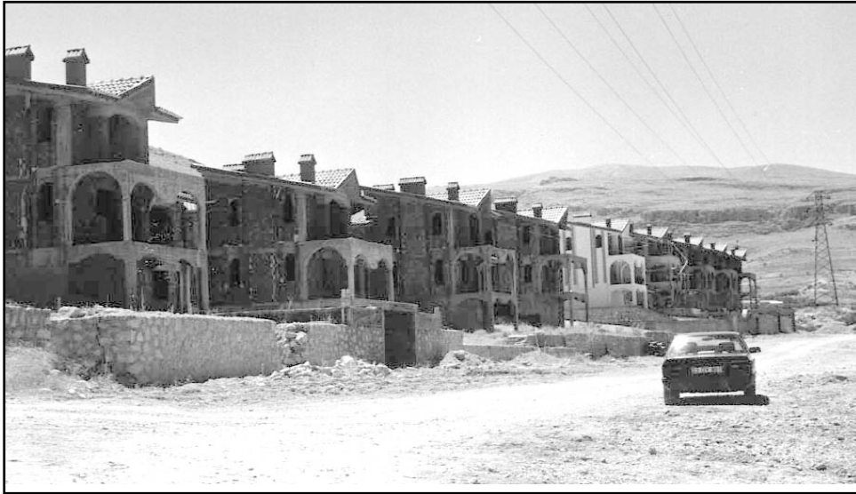
Foto 6: Evler inşa aşamasında iken zemin problemleri nedeniyle istinat (1) ve ev duvarlarında (2) yarıklar oluşmuş, bunları önlemek amacıyla kiltaş kalker kontağından çıkan kaynaklar drene edilmiş ve istinat duvarları yapılmıştır.
