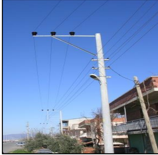
Resim 2. 10 Beton direk ile yol aydınlatması görüntüsü
