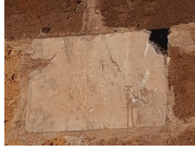
Resim 186. Sâhib Ata (İshaklı) Kervansarayı'nın Avlusunda Bulunan Köşk Mescidin Kible Duvarında Bulunan Devşirme Malzemeler (Detay 3)
