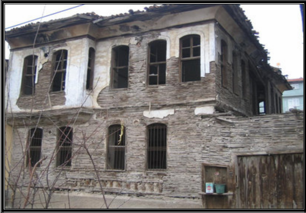
Foto 14. Yıkılmaya Yüz Tutmuş Bakımsız Bir Ahşap Konut.
