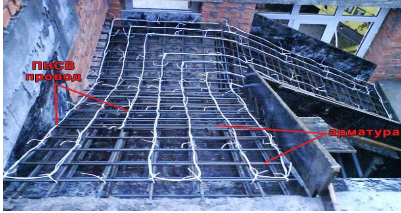
Resim 2.4 Kablo döşeme sistemi ile ısıtma.
