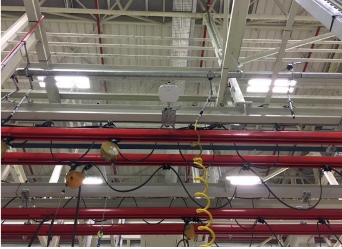
Resim 3.7 İstasyonu Kapsayacak Şekilde Monte Edilmiş RTLS Anteni
