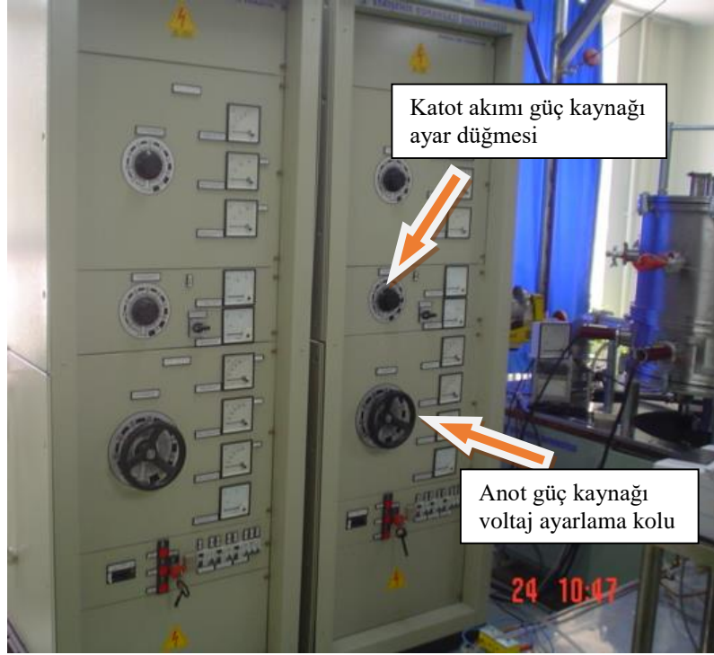
Şekil 3.6 Katot akımı güç kaynağı ve anot potansiyeli güç kaynağı panosu.
