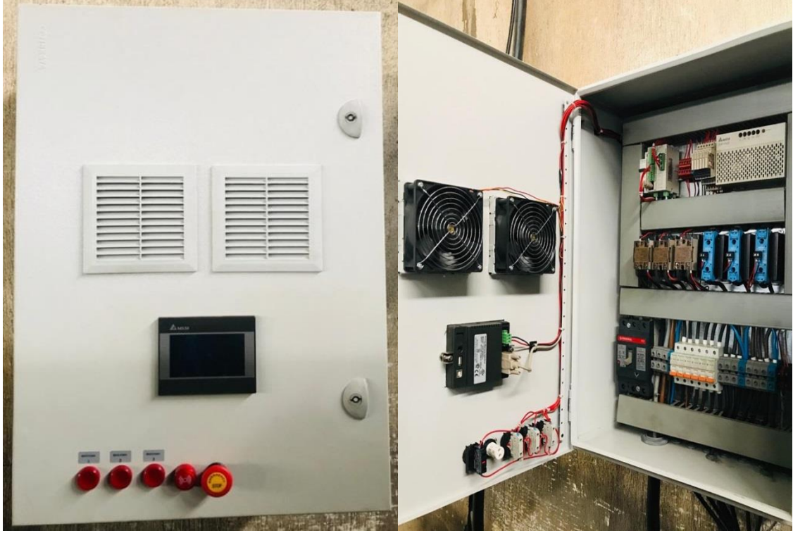
Resim 4.7 Isıl iřlem fırını elektrik kumanda panosu.
