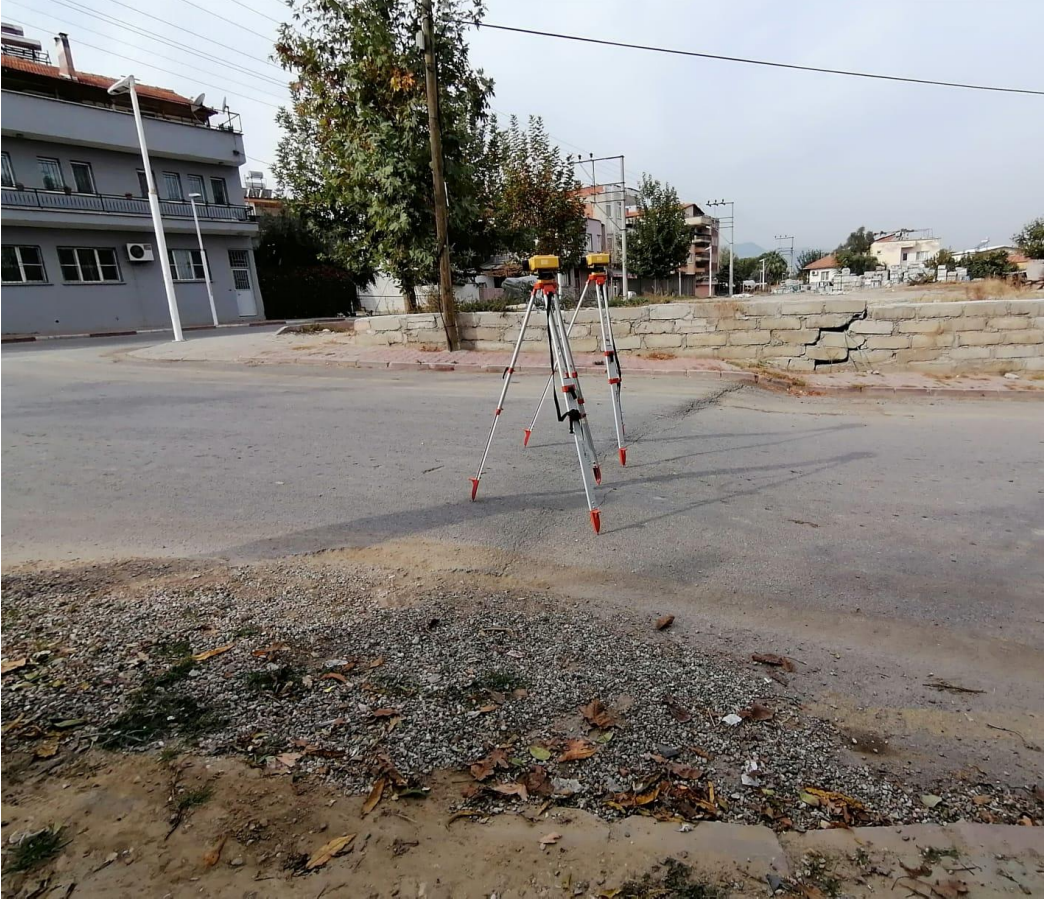
Resim 5.2 C Güzergâhı 303-304 numaralı direkler arasındaki yüzey deformasyonu (13.03.2020).
