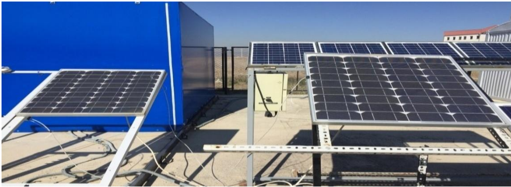
Resim 3.6 Güneş panellerinin monte edilmiş hali.
