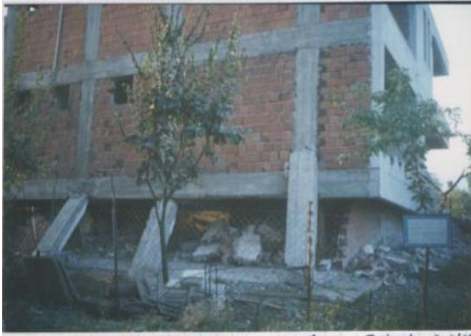
Resim 3.2 Gölcük – Körfez Yukarı Mahalle’de Zayıf Kat Hasarı (Tezcan vd. 2007).
