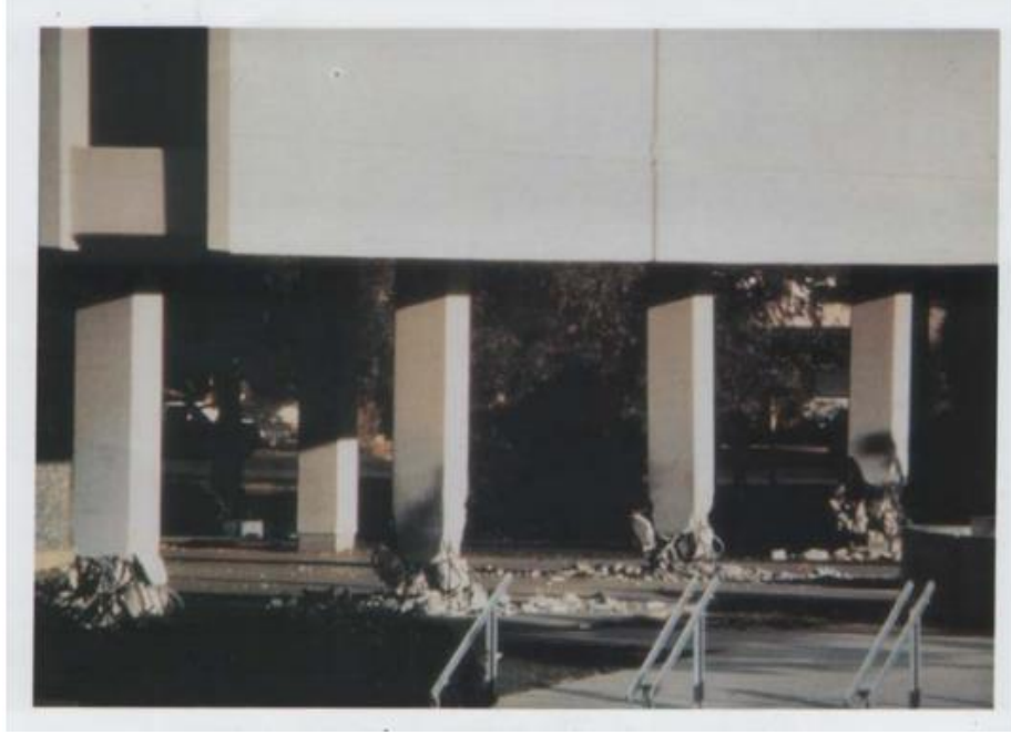
Resim 3.1 Imperial County Belediye Binası Zayıf Kat Hasarı (Tezcan vd. 2007).
