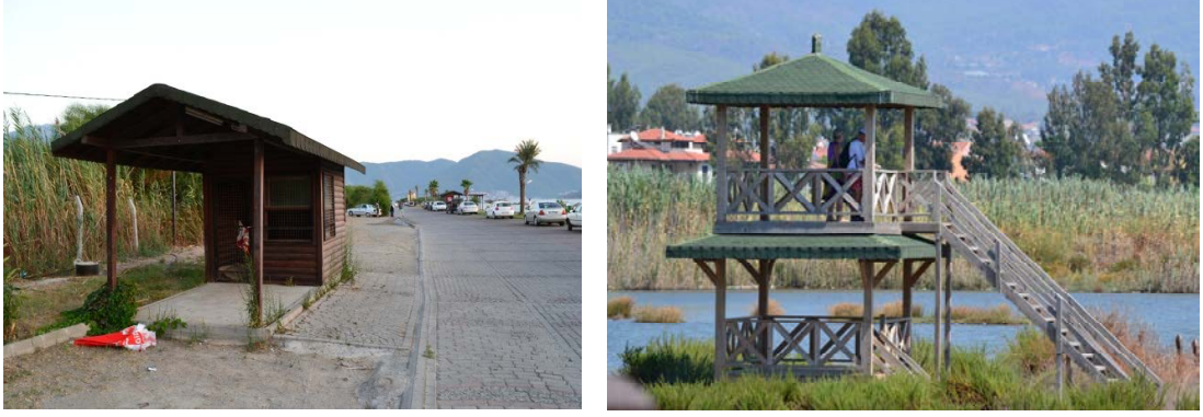
Foto 26: Sulak Alanın giriş kapısındaki kullanılmayan danışma ve güvenlik kulübesi ve planlara uygun yapılmayan kuş-gözlem kulesi
