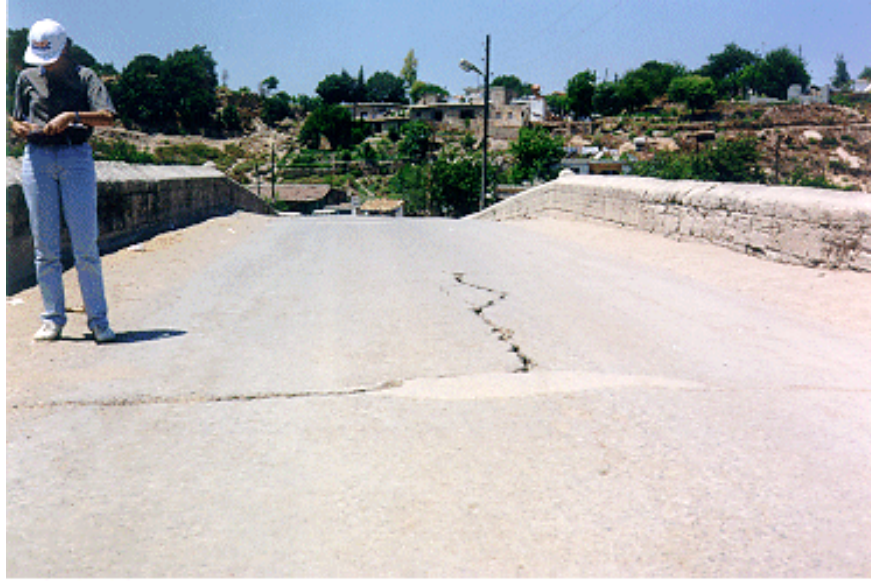
Foto 12: Misis Köprüsü Üzerinde Oluşan Hasar (Bayülke, 1998).
