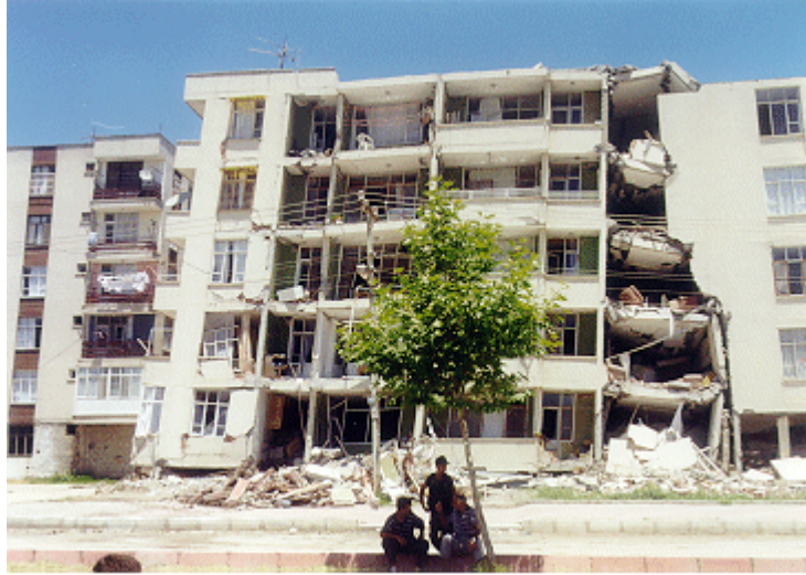
Foto 17: Yıkılmış Kooperatif Binası (Bayülke, 1998).
