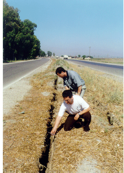
Foto 8: Adana-Gaziantep Yolundaki Otoyol Hasarı (Bayülke, 1998)
