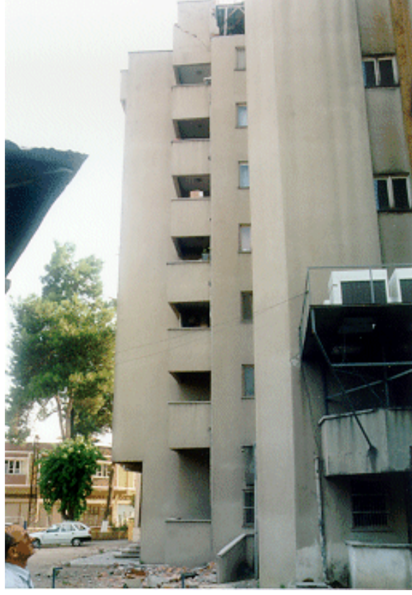
Foto 15: Telekom binasında yıkılan kalkan duvarı (Bayülke, 1998).
