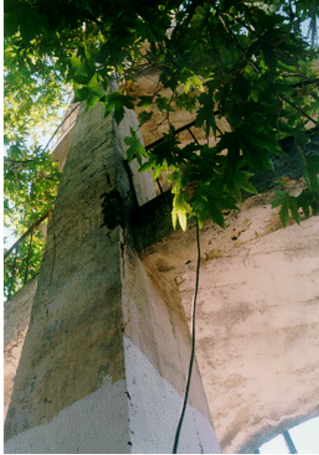
Foto 13: Geçitli Su Kulesinde Oluşan Hasar (Bayülke, 1998).
