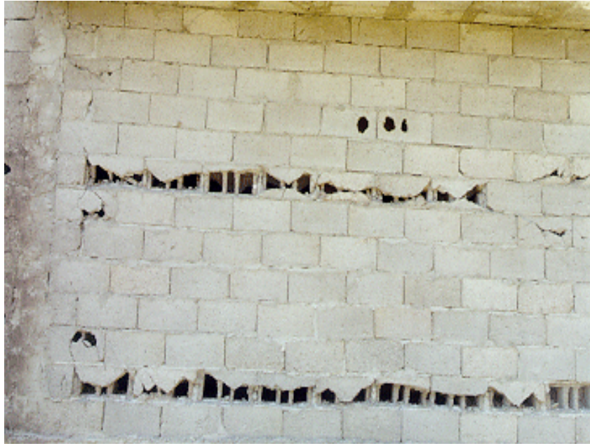
Foto 14: Briket dolgu duvarda kesme kırılması (Bayülke, 1998)
