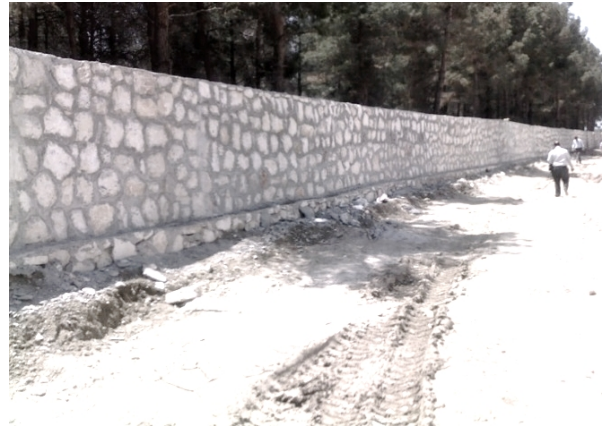
Şekil 4. Burdur'da mermer parça atıklarından teşkil edilen bir taşkın koruma duvarı (DSİ, 2009)
