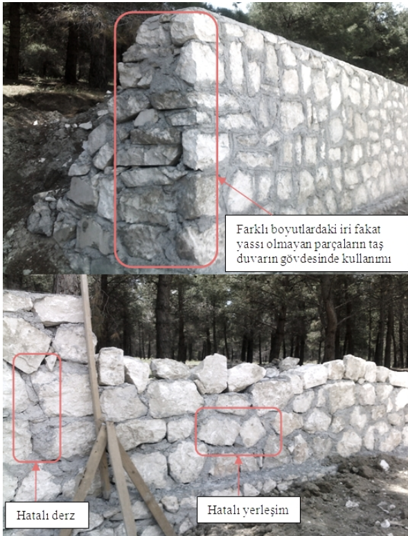
Şekil 5. Mermer bloklarından ve parça atıklarından teşkil edilen taşkın koruma duvarı (DSİ, 2009)
