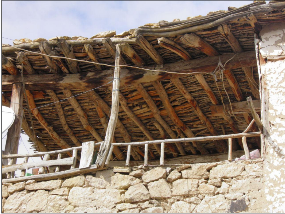
Foto 51. Ayazini Evleri Çatı Örtüsü
