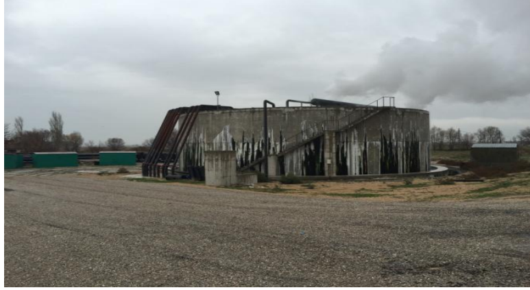
Resim 5.16 Şehir ısıtma hattı jeotermal akışkan toplama havuzu ve jeotermal kuyu bağlantıları.
