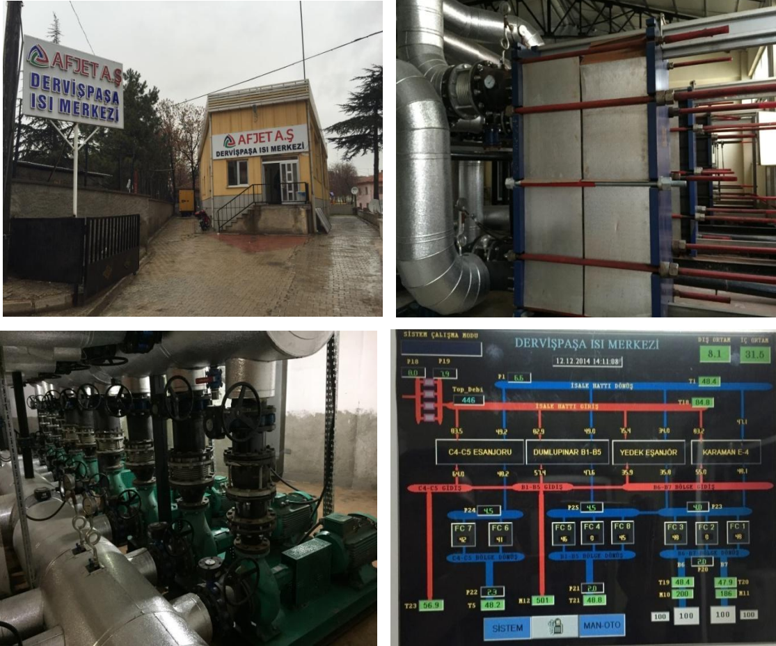
Resim 5.31 Dervişpaşa ısı merkezinde plakalı eşanjörler, santrifüj pompalar ve elektronik kontrol paneli.
