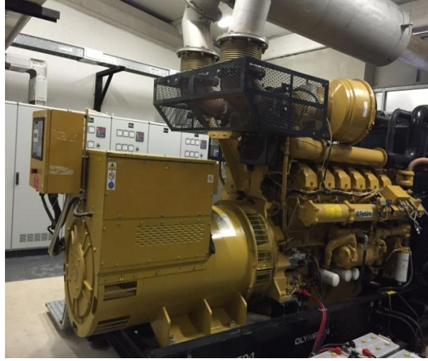
Resim 5.22 3000 KW kapasiteli jeneratör.
