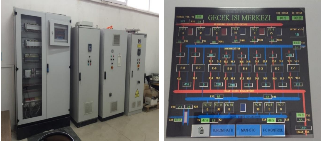
Resim 5.23 Ömer- Gecek ısı merkezi elektronik kontrol üniteleri ve kontrol paneli.
