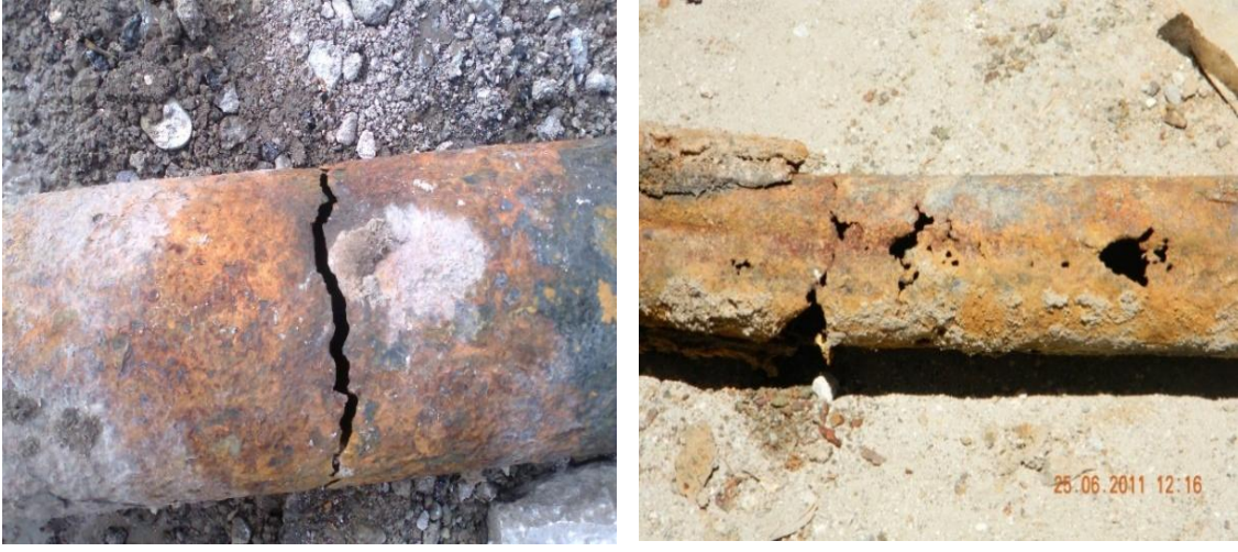
Resim 5.8. İsale hattındaki borularda meydana gelen korozyon.
