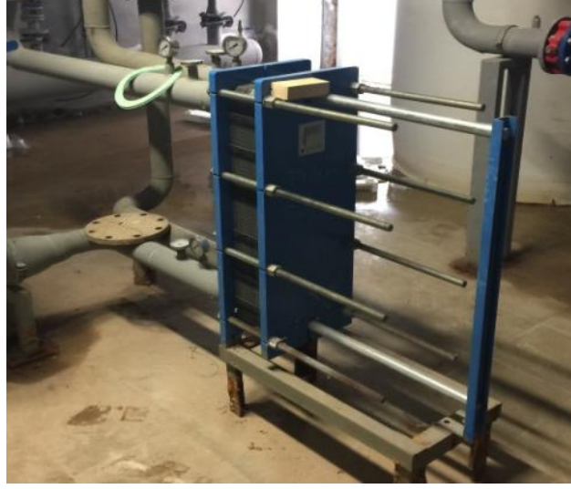
Resim 5.10 Bina altı ısı eşanjörü.
