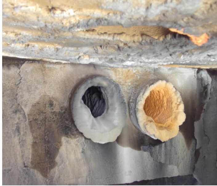
Resim 5.4 Jeotermal sondaj kuyularında kalsiyum karbonat kabuklaşması
