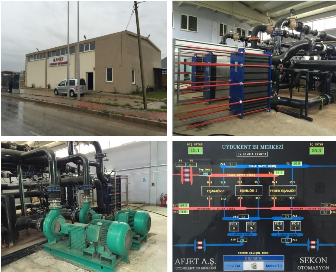
Resim 5.28 UyduKent ısı merkezinde plakalı eşanjörler, santrifüj pompalar ve elektronik kontrol paneli.
