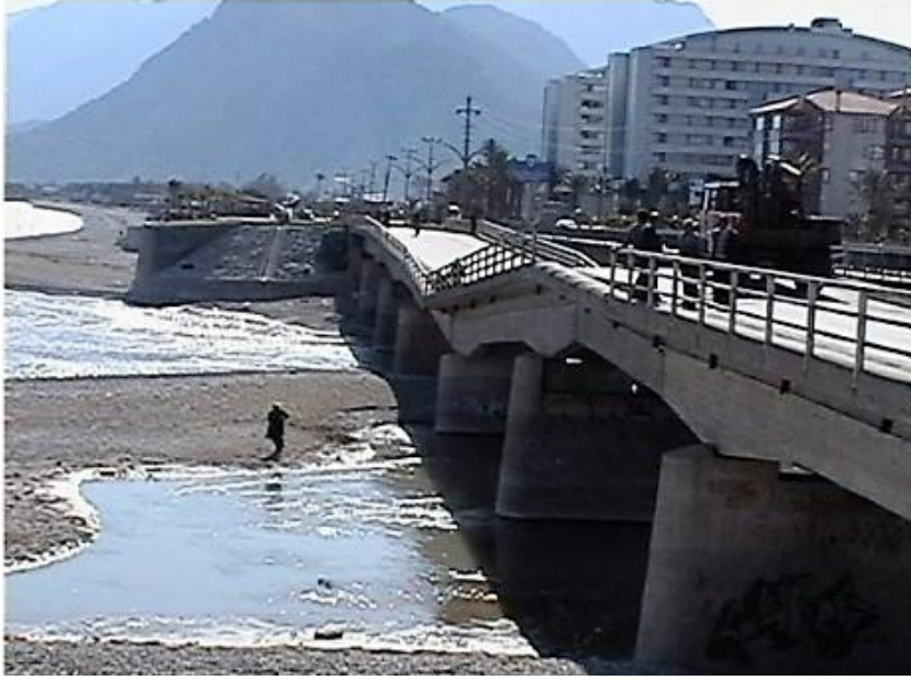
Resim 3.7 Taşkın sonrası boğaçay köprüsünün durumu (Çevik vd. 2005).
