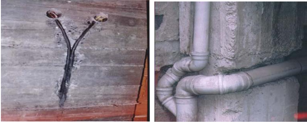
Şekil 2.2 Tesisat İçin Hasara Uğratılmış Taşıyıcı Elemanlar (Koçak 2003)
