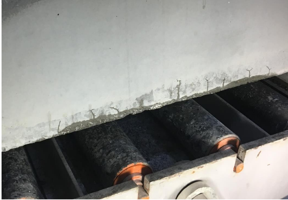
Resim 4.4 Aseton sıkıldığında ortaya çıkan kılcal çatlaklar.
