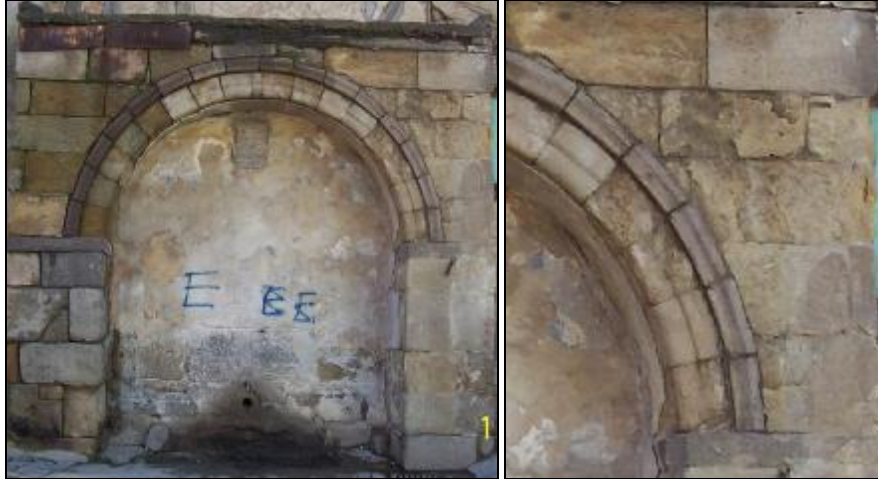
Şekil 1 Apti Kadı çeşmesinde görülen doğal taş bozuşmalarının görüntüsü.
