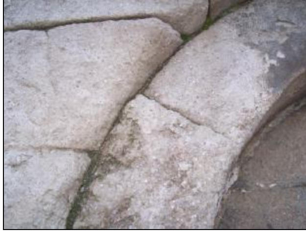
Şekil 8 Hacı Nasuh Camisi Çeşmesinde tüflerde gözlenen bozuşmalar.
