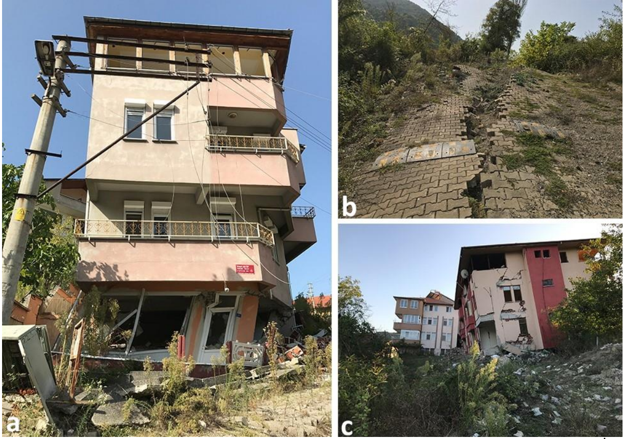
Şekil 14. a: Boşaltılan yerleşim alanında akma nedeniyle zemin katı deforme olmuş bir bina. b: Yıkılan Devrek İmam Hatip Lisesi yolunda arnavut kaldırımının ortasından boyuna yarılması. c: Adeta deprem sonrası görüntüsü gibi duran ancak heyelan sebebiyle zarar görmüş evler.
