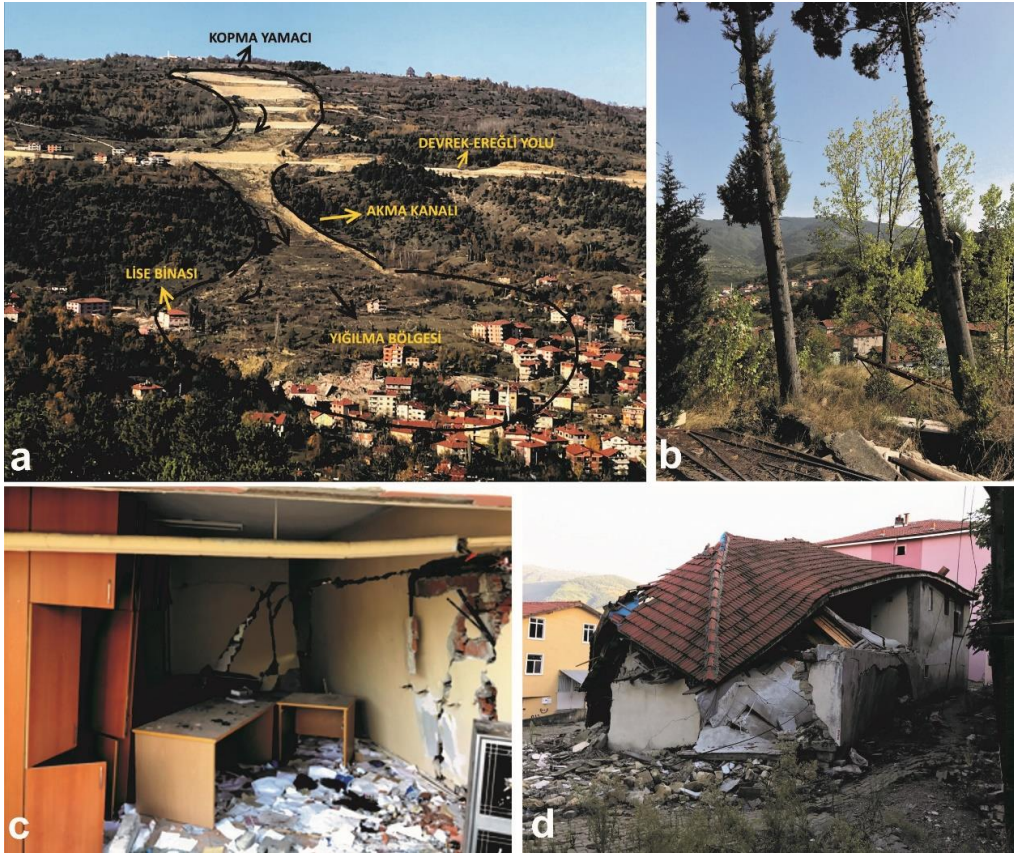
Şekil 13. a: Heyelan'ın kopma yamacı, akma kanalı ve yığılma bölgesi. b: Heyelan sebebiyle eğilmiş Servi ( Cupressus sempervirens ) ağaçları c: Devrek İmam Hatip Lisesi'nde heyelan nedeniyle oluşan deformasyonlar. d: Heyelan sebebiyle kullanılamaz hale gelmiş bir ev.
