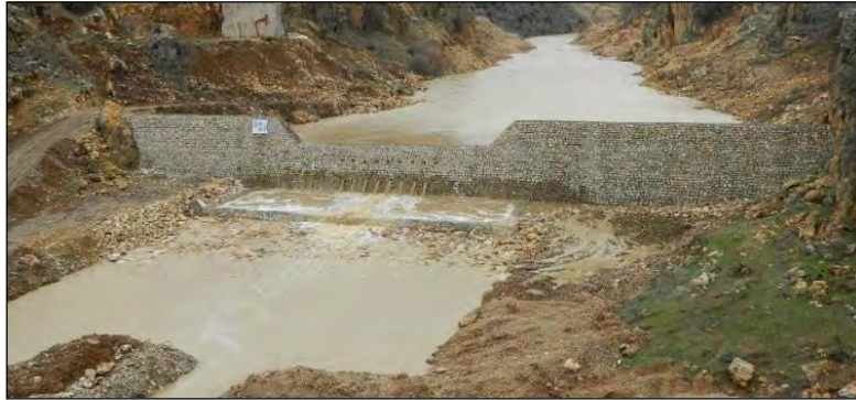
Foto 24: Kufi Çayı Tersip Benti (Kufi Çayı üzerinde inşa edilen tersip ve kesif bentleri ile taşkın ve rusubat kontrolü sağlanması amaçlanmıştır. Işıklı Gölü'ne taşınan malzemenin engellenmesiyle gölün dolmasının önüne geçilmesi asıl hedeftir. Foto kaynak DSİ).
