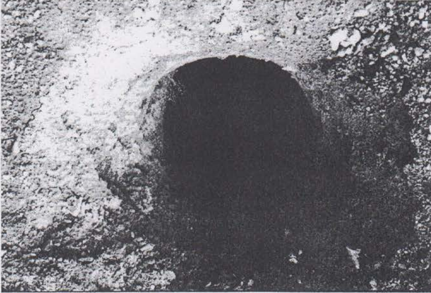
Foto 6: Keban Baraj gölü 832.5 m kotunda iken oluşan 80 cm. çapındaki su kaçağı boşluğu görülmektedir (Foto: N.Özgen).
