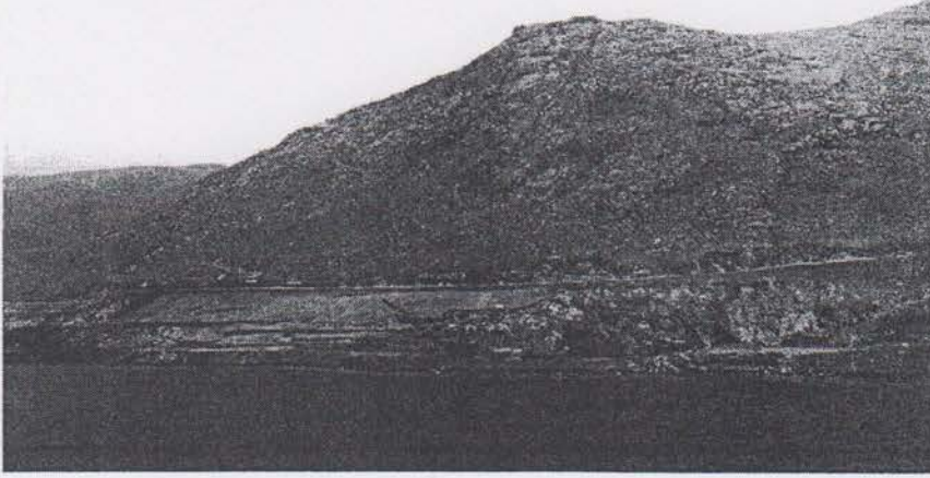
Foto 5: Keban barajı sol sahilinde su kaçaklarını önlemek amacıyla yapılmış çalışmalar. Burada bulunan Petek mağarası ağız kısmı hafriyatla doldurulmuş ve yamaç beton dökülerek kaplanmıştır. Bu durum Keban barajının maliyetinin çok artmasına neden olmuştur.
