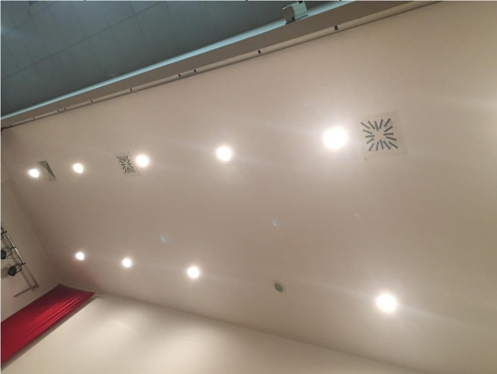
Şekil 73. Sahne Tavanının Spot Lamba İle Aydınlatılması
